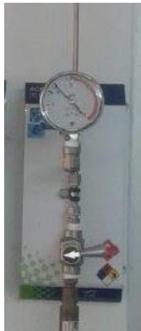
Ilustración 16. UMPT instalado en pared.
